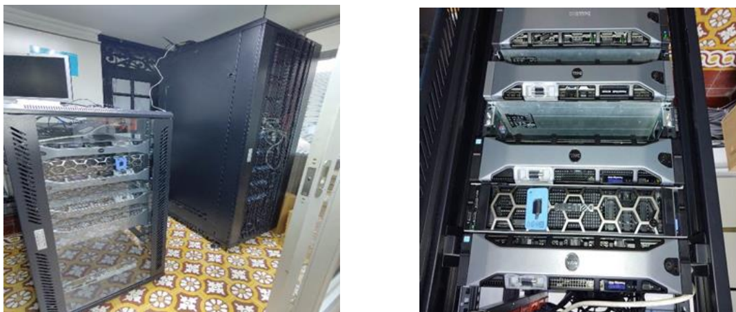
Figura 5.4 Equipos para el datacenter.
