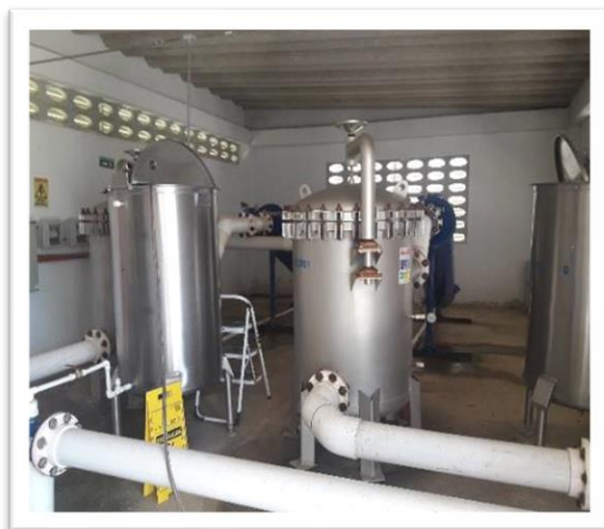
Equipos de Dosificación.
