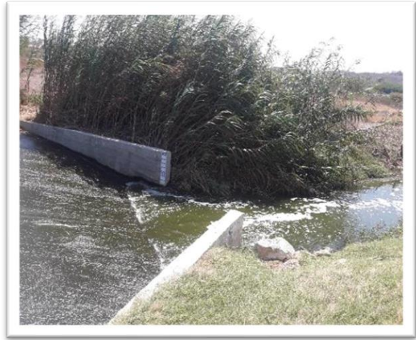
Punto de conexión canal de Biorremediación.
