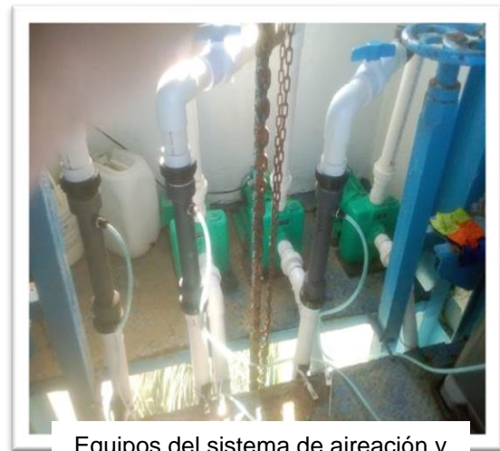
Equipos del sistema de aireación y recirculación.
